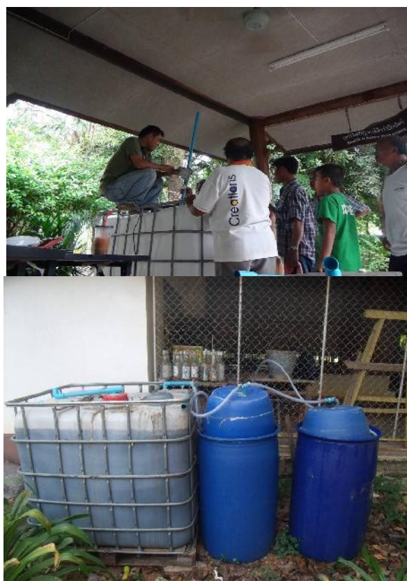
ภาพที่ 7 ถังหมักก๊าซชีวภาพที่ติดตั้งและใช้งานในโรงเรียนบ้านเปร็ดใน
